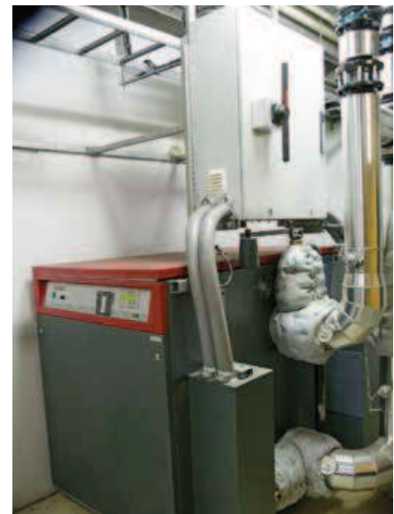
Inmiddels is een elektrische ketel aangeschaft ter aanvulling van de warmtepomp.
