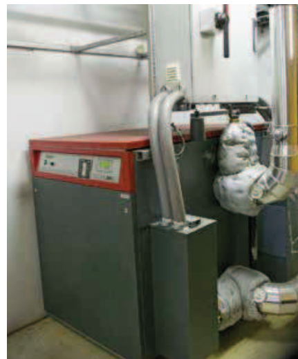
Inmiddels is een elektrische ketel aangeschaft ter aanvulling van de warmtepomp.
